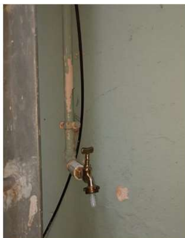
Dia 25/06/2020 - Vazamento d'água por quebra de uma torneira.
