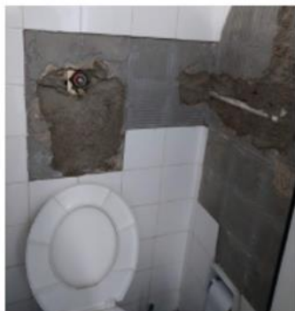
Fechamento em alvenaria e aplicação de emboço na parede do banheiro do 2º e 3º andar do bloco D - Campus Praia Vermelha
