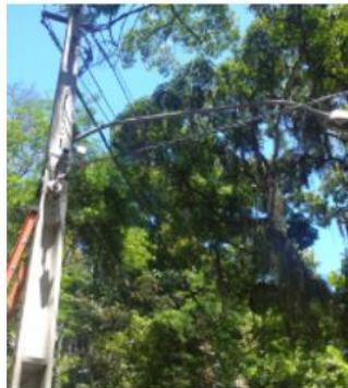
Suspensão dos cabos de telefonia, dados, câmera de CFTV do Campus Valonguinho que despencaram do poste após a queda da árvore
