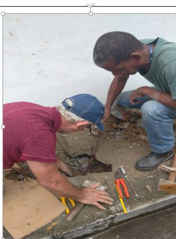
Dia 13/02/2020 - Cabo subterrâneo que vai para a procuradoria que estava em curto foi desligado e consertado na Reitoria.
