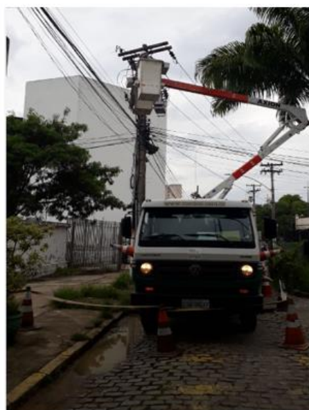
Dia 06/02/2020 - Restabelecimento da Energia pela empresa Enel no campus Gragoatá.
