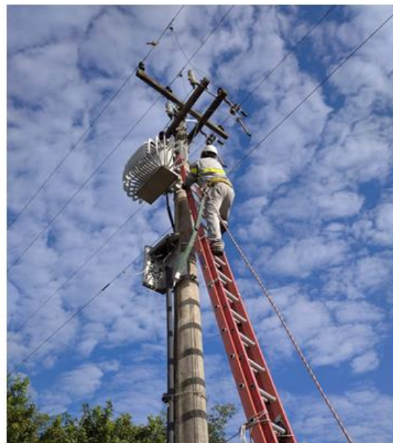
Dia 10/08/2020 - Manutenção preventiva nas subestações simplificadas da Educação Física e Moradia Estudantil no Campus Gragoatá.
