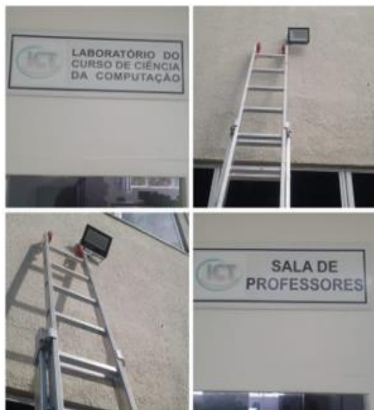
Dia 16/02/2022 - Instalações de refletores de 100w na área externa do ICT em Rio das Ostras.
