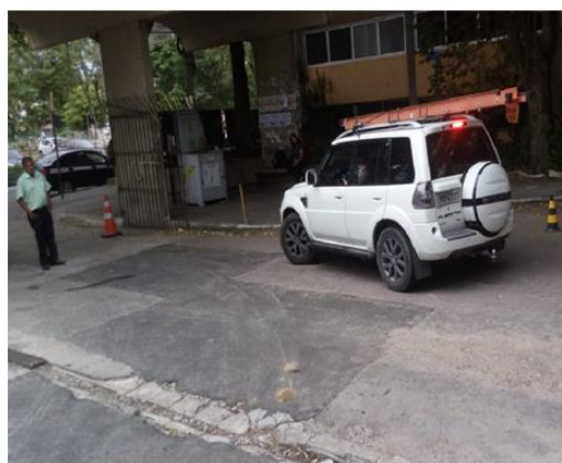
Dia 17/03/2020 – Regularização da energia do NAL do Campus Valonguinho.
